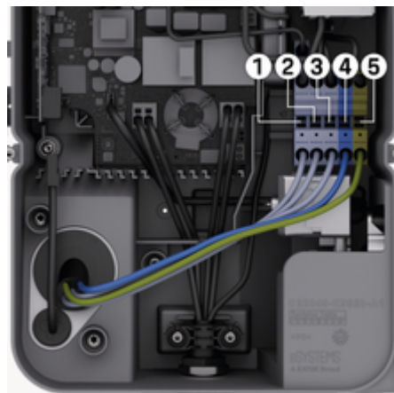
Fig. 23: Bornes de raccordement (en triphasé)
